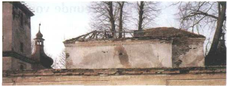
Muttergotteskapelle. Dachziegel entfernt, Gewölbe zum Teil eingestürzt.
